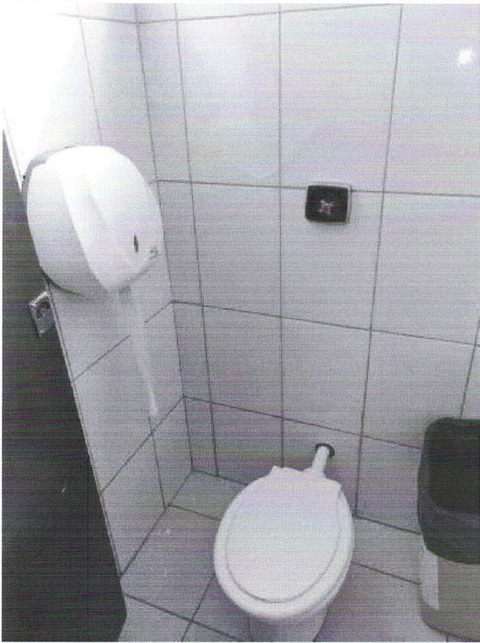
banheiro com o equipamento instalado de higiene
